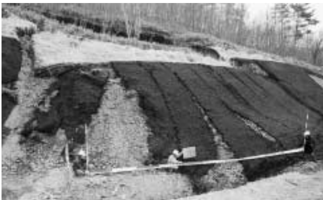
改良中の板橋笹渡線 降雨により崩れたのり面
