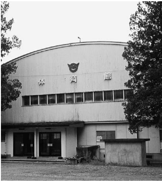
雨漏りの発生など老朽化が進む町体育館
