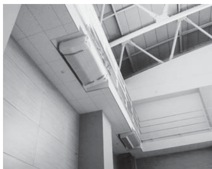
アリーナに設置された空調設備
