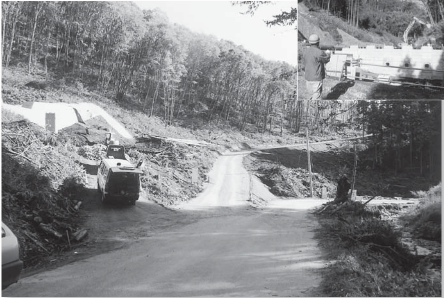
砂防ダム工事で通行止めされた町道（右）に設置された工事用道路（中央）は、現在、迂回路として利用されています（左上は建設中の砂防ダム）
